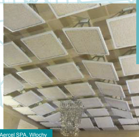
Aercel SPA, Włochy
